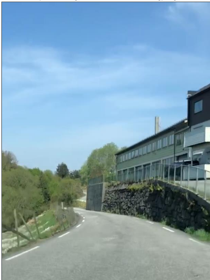
Bilete 3: Krappe kurve med dårleg sikt, skjeringar og fyllingar, med liten eller ingen plass på utsida av kvitstripa på fv.409 Radøyvegen retning nord, fartsgrense 50 km/t.
